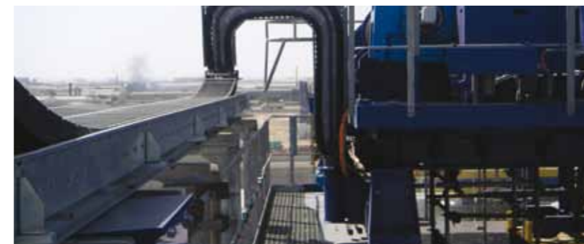
igus®-Rinne montiert auf dem RTG-Träger: igus® bietet spezielle maßgeschneiderte Rinnen zum Schutz der readychains® gegen die verschiedensten Wittereinflüsse.
